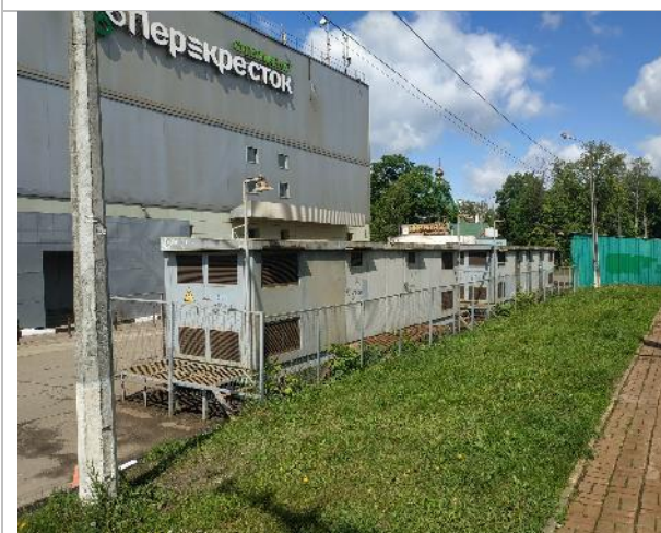
Фотография 63. Трансформаторная подстанция.
