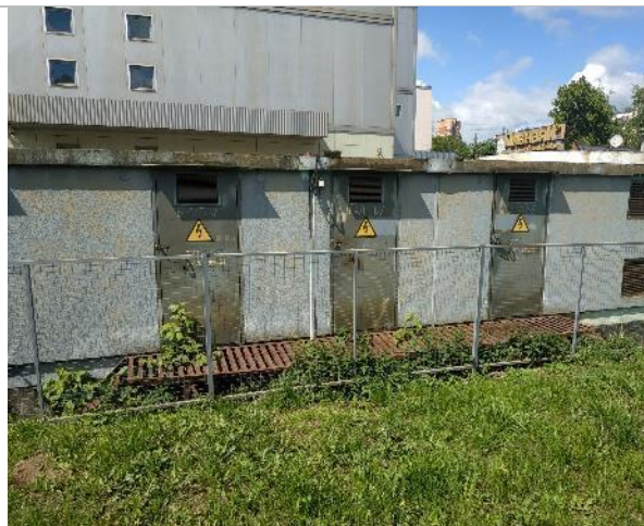
Фотография 66. Трансформаторная подстанция.
