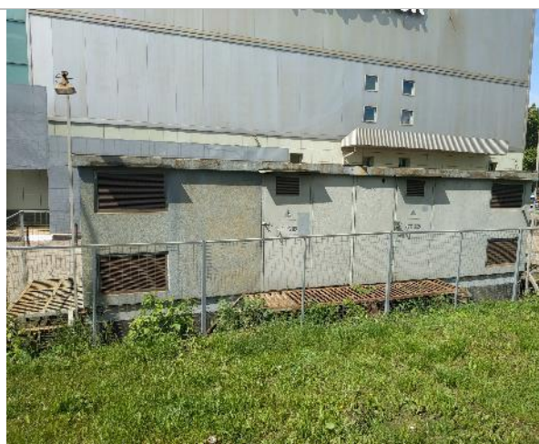
Фотография 64. Трансформаторная подстанция.
