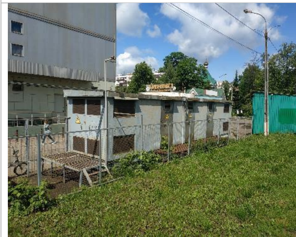
Фотография 65. Трансформаторная подстанция.
